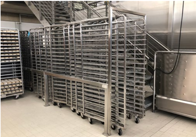
Eigens angefertigt: das Geländer aus Edelstahlrohren definiert die Stellfläche der Wagen in der Produktion
